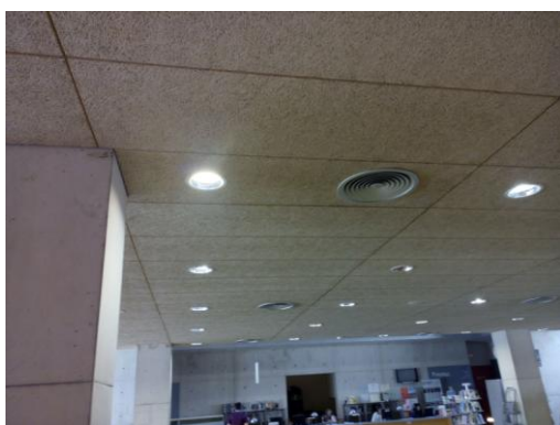
Figura 3. Unitats terminals de climatització
