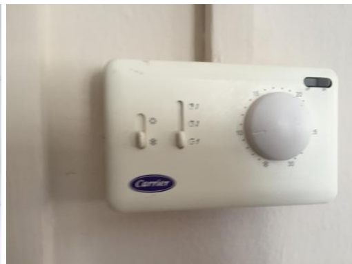
Figura 4. Termòstats de climatització
