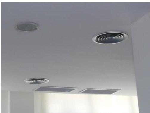
Figura 5. Unitats terminals de climatització
