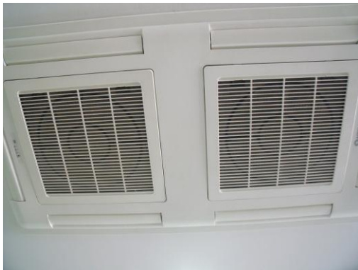
Figura 3. Unitats terminals de climatització
