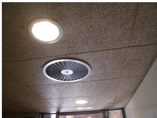
Figura 5. Unitats terminals de climatització
