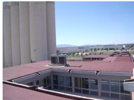
Figura 4. Bomba de calor aire- aire
