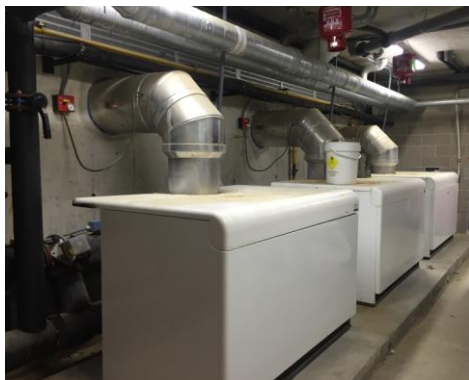
Figura 3. Calderes de gas
