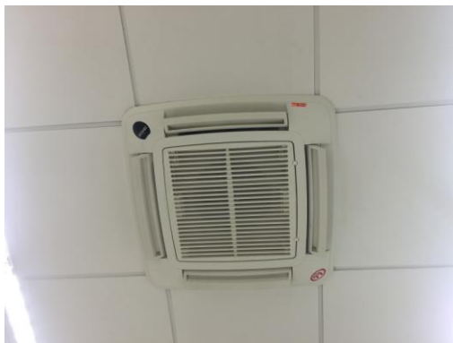
Figura 3. Unitats terminals de climatització
