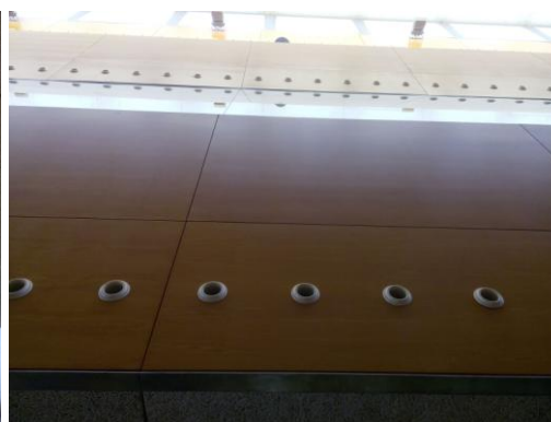
Figura 4. Unitats terminals de climatització
