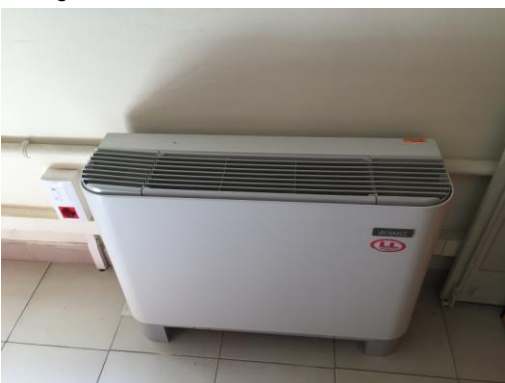
Figura 5. Unitats terminals de climatització
