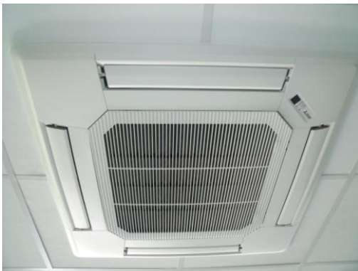
Figura 3. Unitats terminals de climatització
