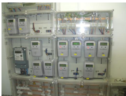
Figura 11. Centralització de comptadors
