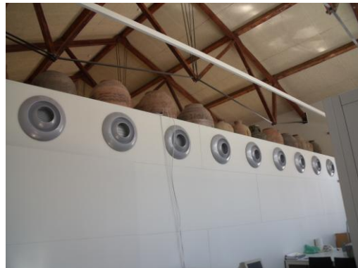
Figura 4. Unitats terminals de climatització
